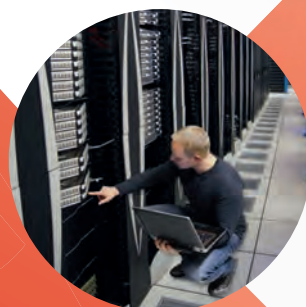
ITMAX SOLUCIÓN DATA CENTER
